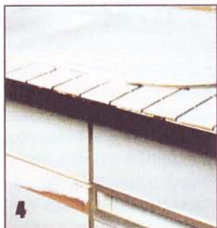
Установив новую раковину, кухонную рабочую плиту облицовывают керамической плиткой и затирают водостойким раствором швы.
