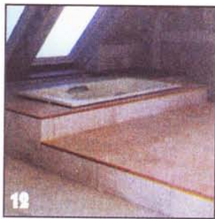
12 Уложив сверху настил из ДСП повышенной водостойкости, можно приступить к облицовке керамической плиткой.
